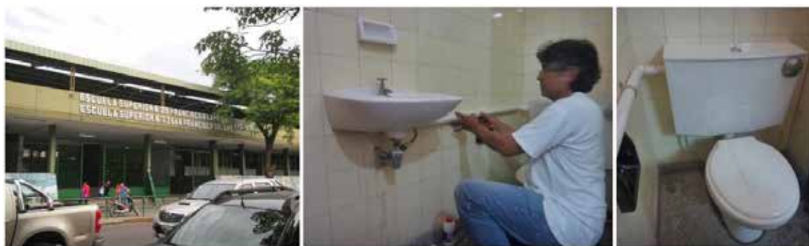
Figura N°11: Sistema implementado en sanitario de dirección, en escuela estatal urbana N°29" Francisco Laprida", ciudad capital de Santiago del Estero. Fuente: Fotografías tomadas por el equipo de trabajo.
