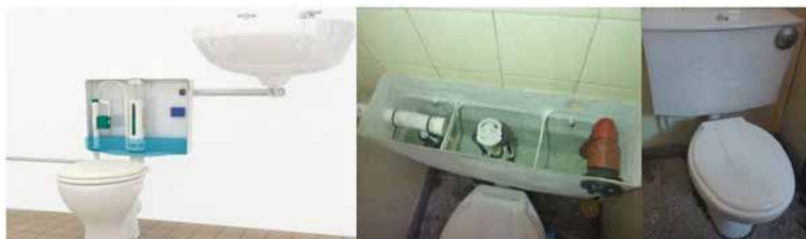
Figura N° 1: Fotorrealismo del diseño y fotografías, materialización e instalación del Sistema ATRAG.
