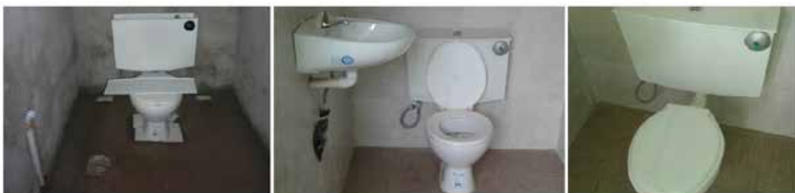
Figura N° 9: Sistema implementado en sanitario de docentes, en Escuela N° 923 localidad "El Hoyón", Departamento Atamisqui, Provincia de Santiago del Estero. Fuente: Equipo de Investigación.
