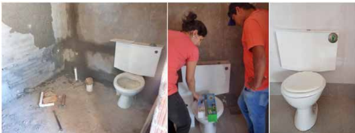
Figura N° 10: Escuela rural, sistema implementado en sanitario docentes, en Escuela N° 71, Loc. La Cañada, Departamento Figueroa, Provincia de Sgo. del Estero. Fuente: Equipo de Investigación
