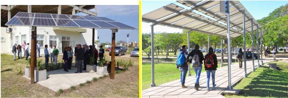
Figura 1: Instalación de un Patio solar en la Universidad Nacional de Nordeste, Resistencia, Chaco con 3 kWp de generación, y Pérgola solar fotovoltaica experimental que genera e inyecta energía eléctrica a la red del edificio de Ingeniería en el campus Deodoro Roca, FaCENA, Corrientes, con una potencia nominal de 6720 Wp. Fuente: www.iresud.com.ar
