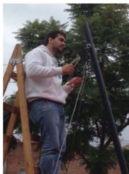
Figura 11: Anclaje para tensores y vinculaciones a la columna metálica. Fuente: elaboración propia
