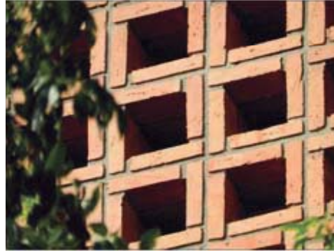
Imagen 8. Detalle del filtro.
