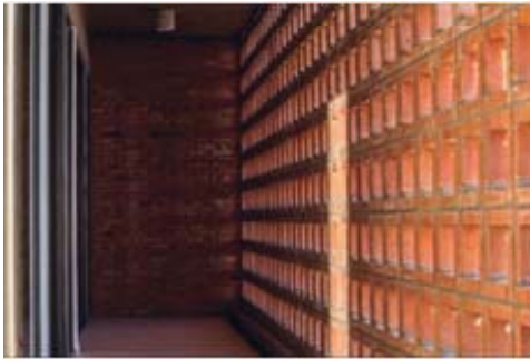
Imagen 6. Interior del filtro.
