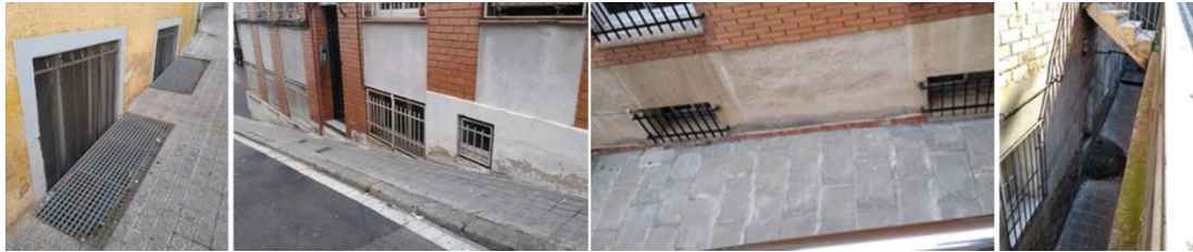
Figura 6: ejemplos de deficiencias de ventilación e iluminación observadas. Fuente: elaboración propia
