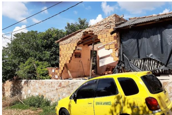
Figura 1: Lambaré. Derrumbe por raudales en Asentamiento Koe Puajhu. Fuente: AR Flores
