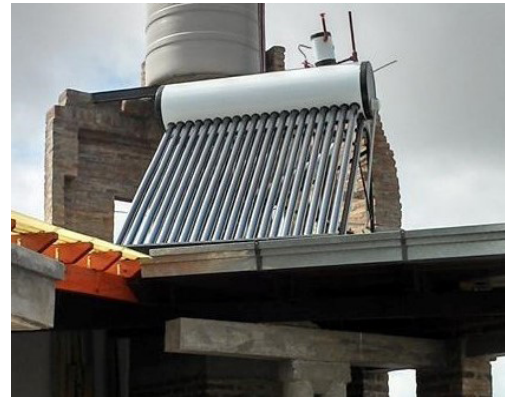
Fig. 18. Termotanque 200 litros ACS
