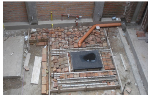
Fig. 22. Tanque reserva y bombeo
