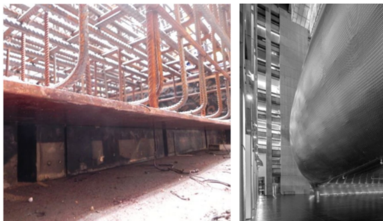
Figura 5 (izq). Muestra las almohadillas de goma sobre las que se montan las columnas. Fuente: Basso (2021).
