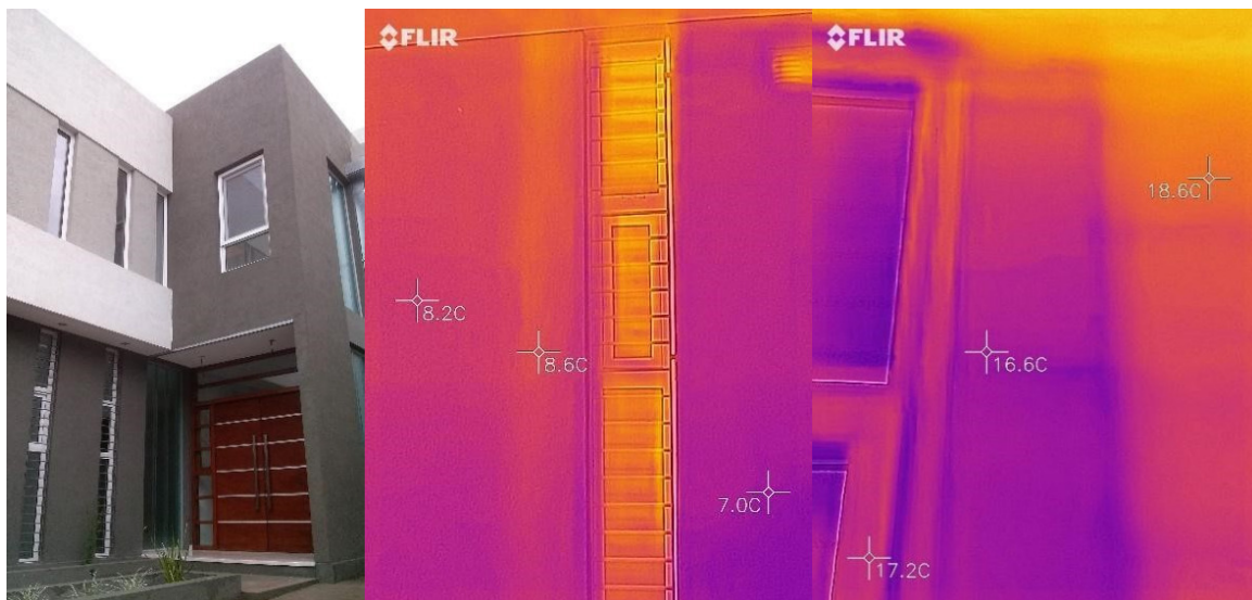
Figura 7: Foto exterior del sector a analizar térmicamente. Imagen termográfica del sector- exterior. Imagen termográfica del sector- interior.
