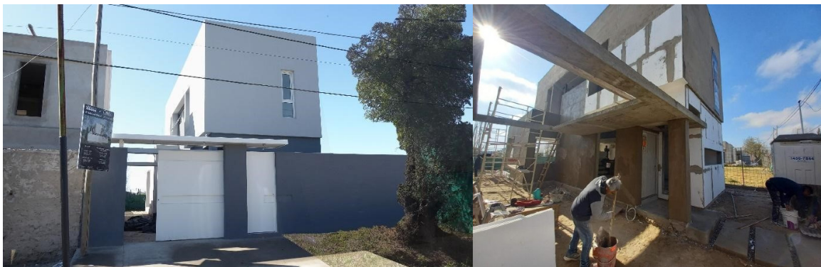
Figura 8: Casa en barrio Roble del Bell, inserción urbana. Foto obra Casa en barrio Roble del Bell. Ejecución del Sistema EIFS.
