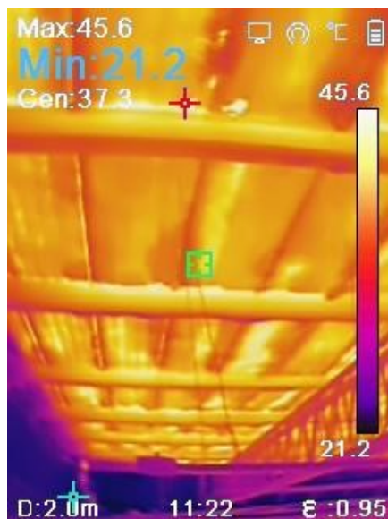
Figura 4. Detalles de la cubierta capturada mediante imágenes termográficas el 14/10/2023 a las 12:25:18. Auditoría propia. Imagen de la cubierta capturada desde el exterior.
