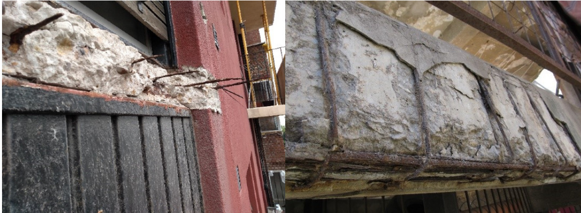
Figura 7. A la izquierda voladizo demolido. A la derecha viga deteriorada.
