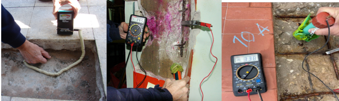
Figura 6. A la izquierda: Medición de tenores de humedad. Al centro: aplicación de fenolftaleína. Al centro y a la derecha: medición de potenciales de corrosión.
