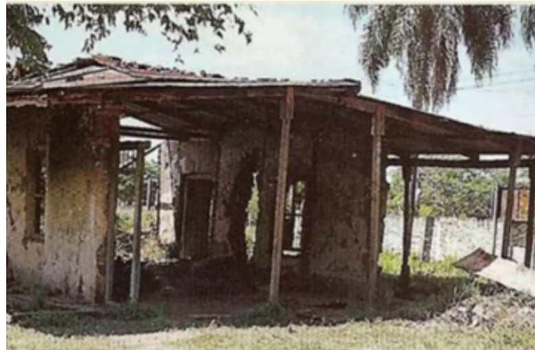
Fig. 3. Foto 2. Casa Galdi. Antes de su recuperación.
