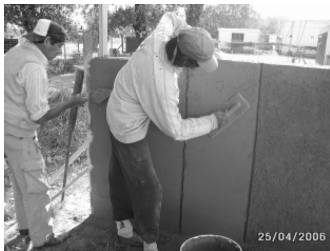
Figura 13: Revoques bicapa sobre tapia Fuente: Rodolfo Rotondaro
