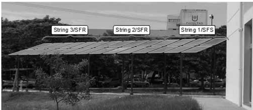
Figura 4 – Distribución de las diferentes cadenas en la estructura de soporte.
