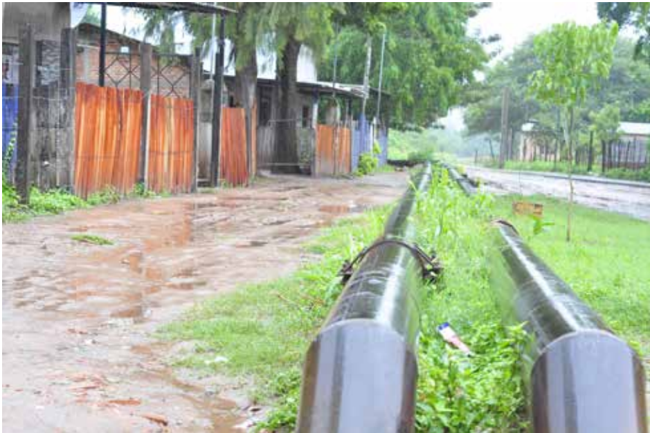
Imagen 10. Tuberías de la destilería que atraviesan la comunidad de Campo Durán, 2020
