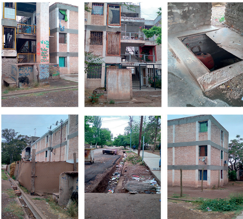
Figura 2. Imágenes del Barrio Parque Sur (2022). Deterioro de los conjuntos, presencia de basura y residuos, presencia de humedad y otros factores relacionados a riesgos para la salud
