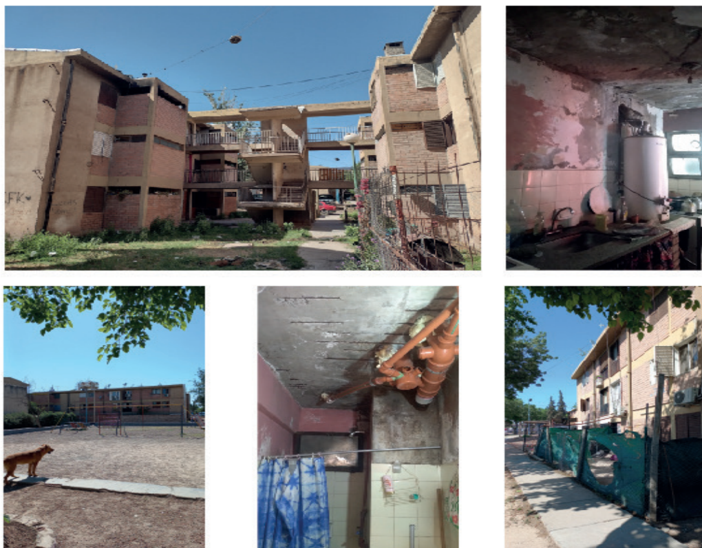
Figura 3. Imágenes del Huarpes II (2022). Deterioro de los conjuntos, presencia de basura y residuos, presencia de humedad y otros factores relacionados a riesgos para la salud
