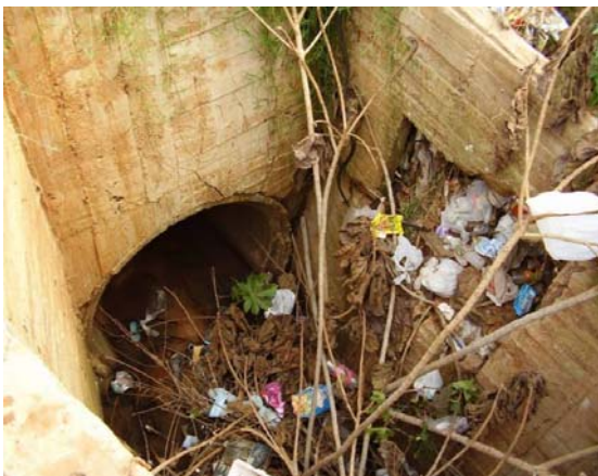
Fig. 10. Presencia de obstrucciones parciales y/o totales de los conductos pluviales
