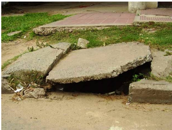
Fig. 8. Deterioro de los conductos pluviales
