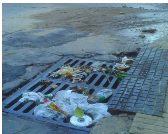
Fig. 3. Drenaje deficiente por acumulación de basura en sumideros o boca de tormenta.
