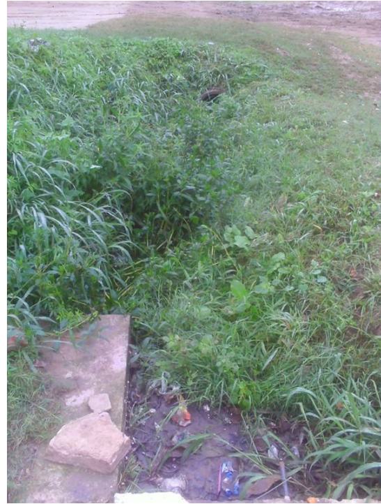
Fig. 5. Drenaje deficiente por actividad biológica acentuada por conexiones clandestinas domiciliarias a zanjás o cunetas.
