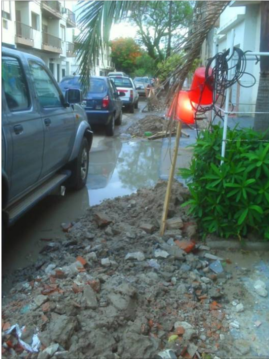
Fig. 4. Drenaje deficiente por excavaciones y depósito de materiales sobre calles y veredas.
